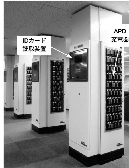
写真2 APD充電器、IDカード読取装置
