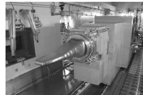
写真3 完成した水銀ターゲットシステム
