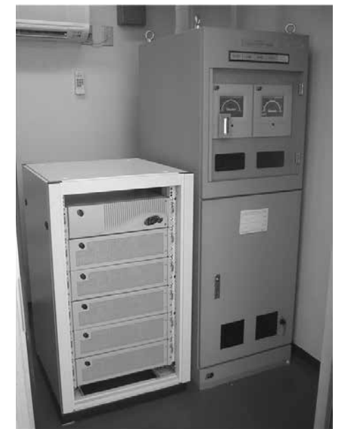
写真2 無停電電源装置外観写真（左）
