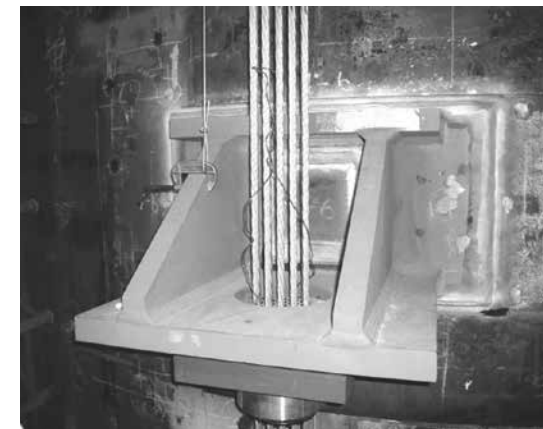
写真8 熱交換器-ストランド接続
