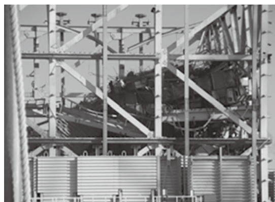
1号機の状況 (瓦礫が見える)
