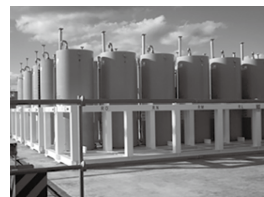
セシウム吸着装置サリーの使用済吸着塔一時保管場所の状況
